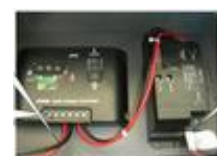
10-Régulateur et transformateur solaires
